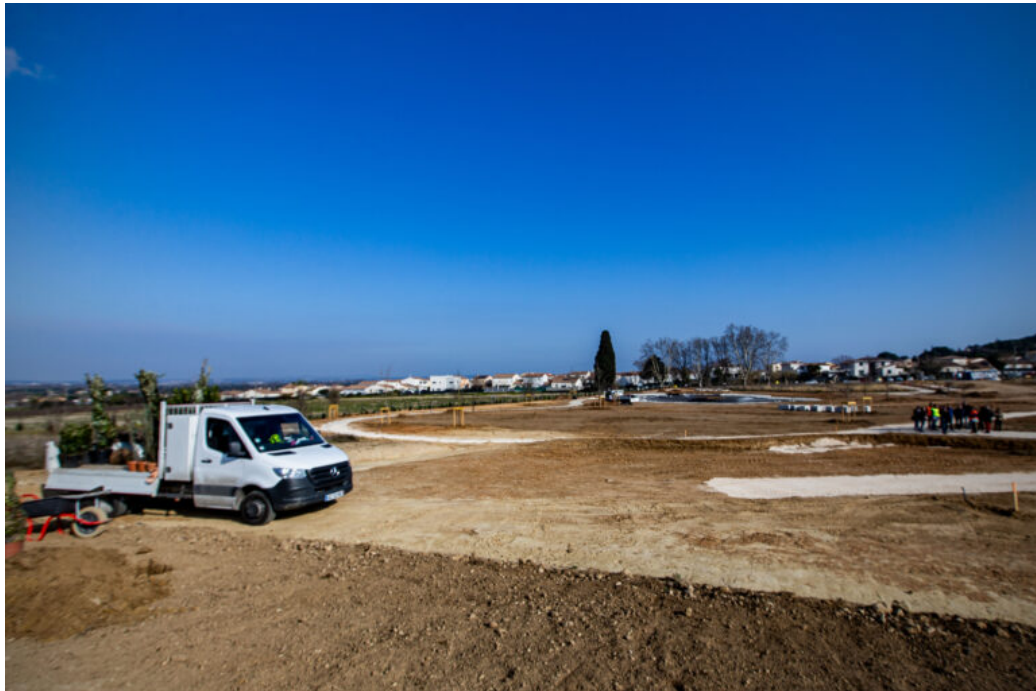
Un chantier de 2,7 hectares qui donnera le jour à un magnifique parc (Photo Yannick Pons)
