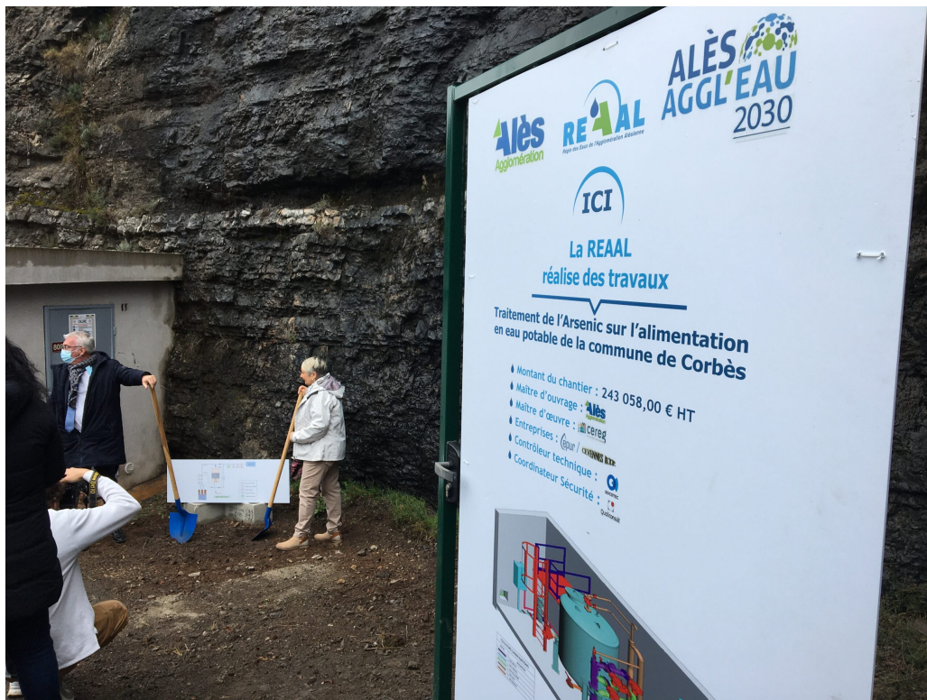
La station de traitement de l'arsenic de Corbès sera opérationnelle cet été. Photo Élodie Boschet/Objectif Gard
