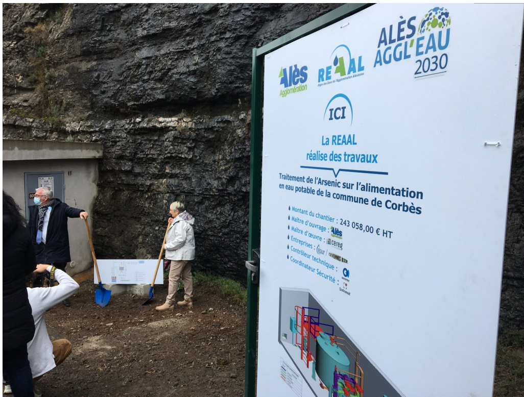
À Corbès, la station de traitement de l'arsenic sera en fonctionnement cet été. Photo Élodie Boschet/Objectif Gard
